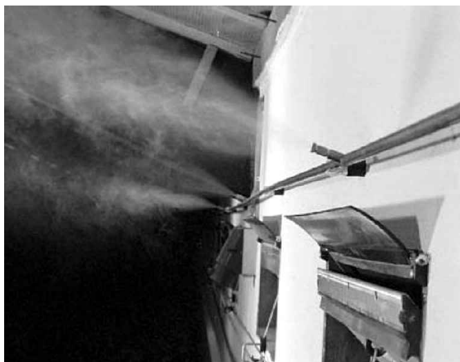
Fotografia 3.9 Instalatie de racire de mare presiune
