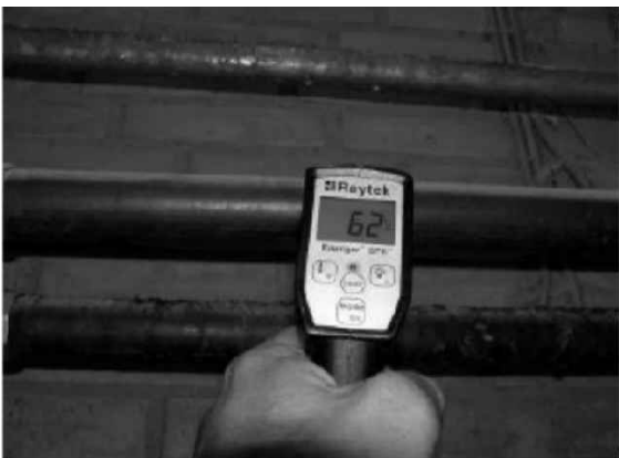
Figura 5.21 Aparat de măsură a temperaturii la nivelul conductelor
