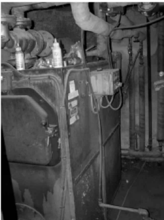
Figura 5.20 Instalație de încălzire veche, pe păcură
