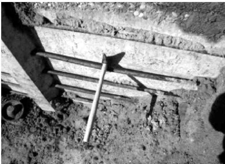
Figura 5.1 Cablurile trebuie să fie decopertate pentru inspecție
